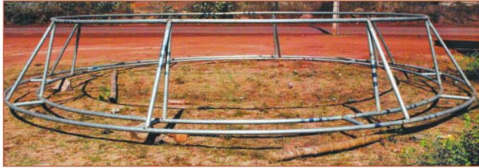
شکل ۵. نمایی از قفس CEGI در حال ساخت، قبل از مرحله پوشش اپوکسی (قطر قفس ۶ متر و ارتفاع از پایه تا نرده ۱۲۰ سانتی متر)
